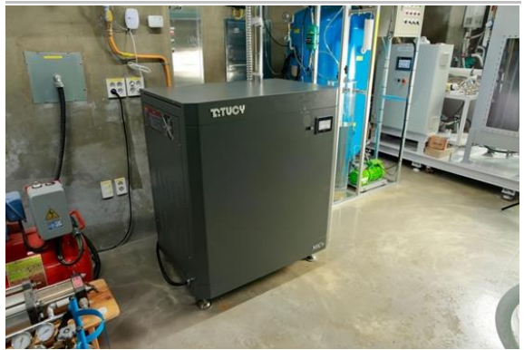
도표 9. SOFC 설치 사례: 울산과학기술원(UNIST)
