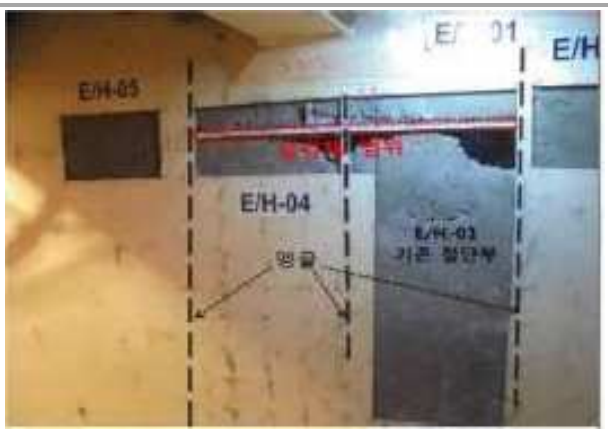
그림26 콘크리트 공극 현상
